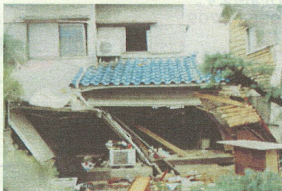
筋かいや壁が少なく大傾斜した例 (阪神淡路大震災)
