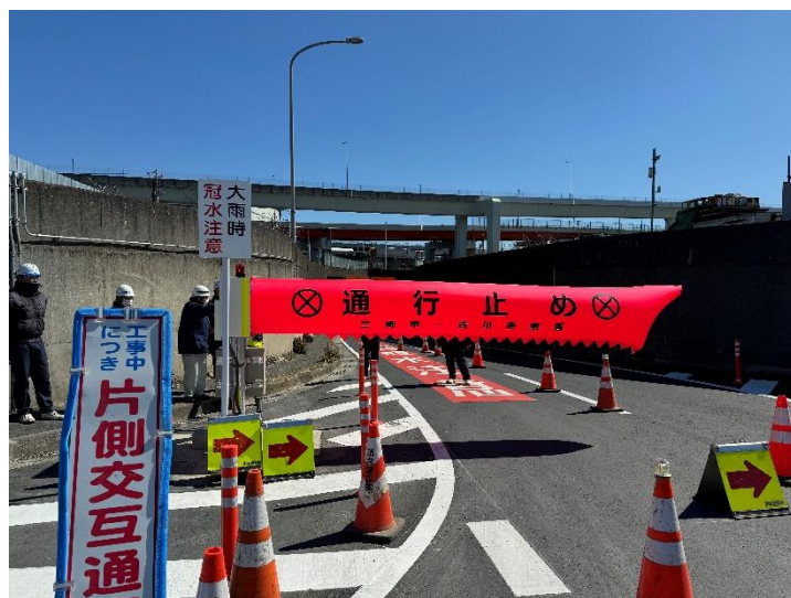
上口側エアー遮断機
