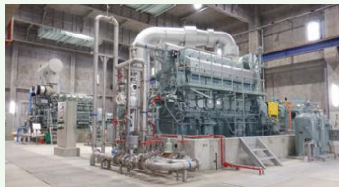
大場川下流排水機場(増強した4号ポンプ)
