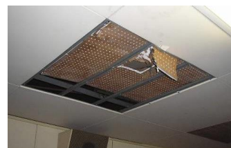
天井材の落下・剥がれ
