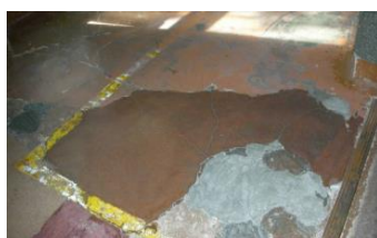
床仕上げの剥がれ
