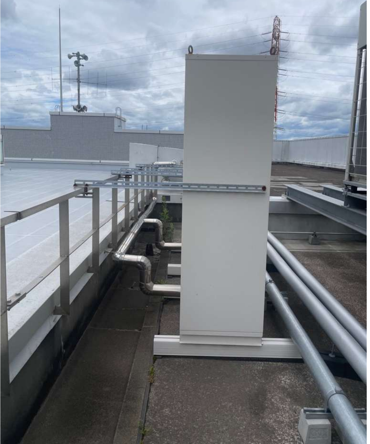
空調用屋外機②
