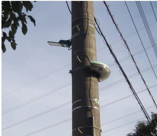
道路照明灯のLED化
