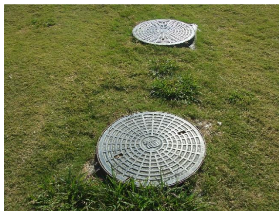
＜電気も敷設されている＞
