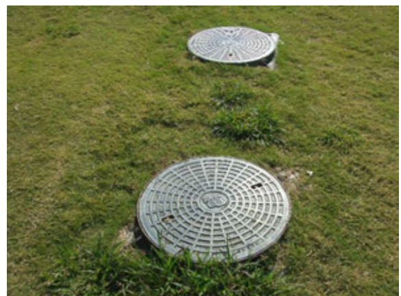
＜電気も敷設されている＞
