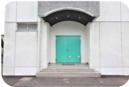
防水扉(北部第二配水場)
