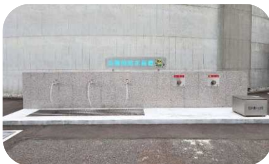
災害時給水装置(北部第二配水場)
