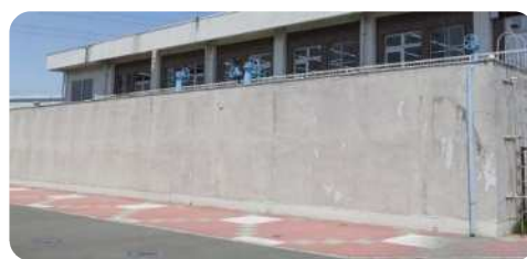
中継ポンプ井
