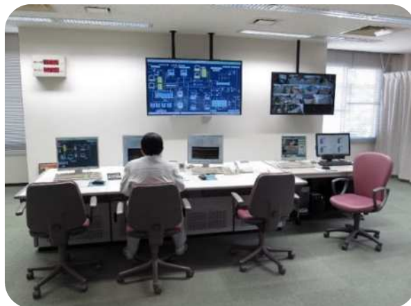
中央監視設備
