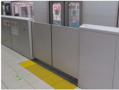
【転落防止用ホームドアの設置】
