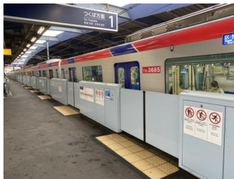
可動式ホーム柵（ホームドア）
