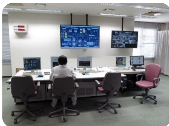
中央監視設備
