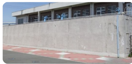
中継ポンプ井
