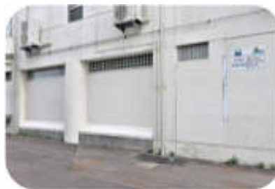
浸水対策壁(北部第二配水場)
