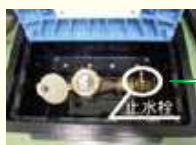
メーターボックス（量水器）内の 止水栓が閉まっている状態
