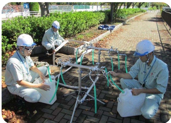
図 3-14.埼玉県営水道 空気弁を使用した応急給水
