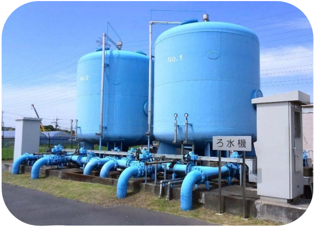
図 3-4.ろ水機（北部浄水場）
