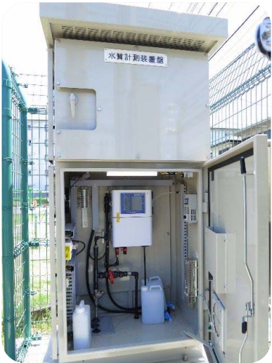
図 3-5.末端水質監視装置
