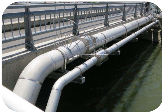
図 3-10.橋梁添架管（寄巻橋）
