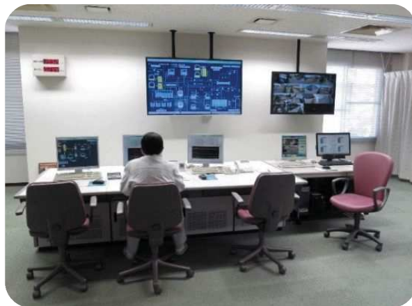
中央監視設備
