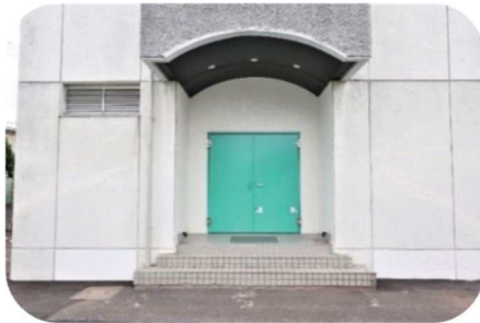
防水扉(北部第二配水場)
