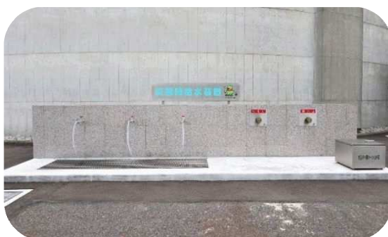
災害時給水装置(北部第二配水場)
