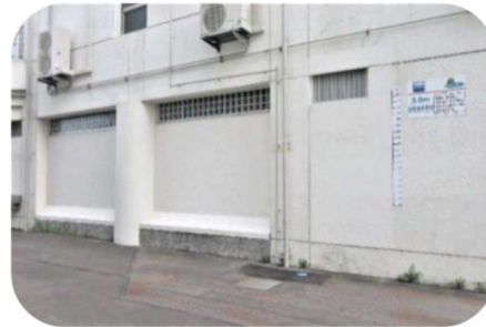
浸水対策壁(北部第二配水場)
