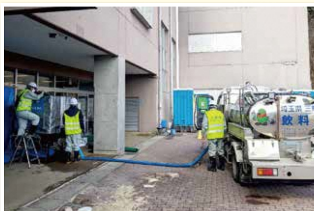
《応急給水拠点(輪島市)での給水活動の様子》
