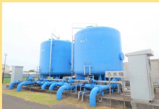
北部浄水場 ろ水機
