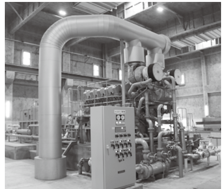
大場川下流排水機場のポンプ
