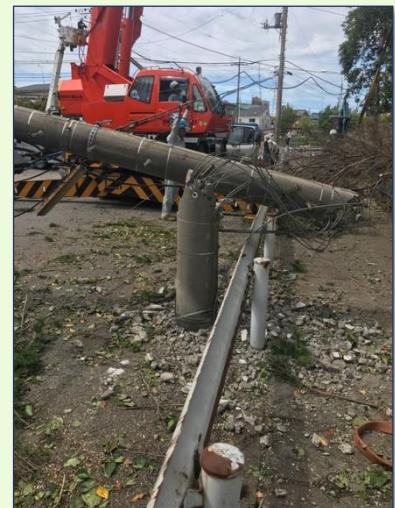
令和元年房総半島台風により 電柱が倒壊した様子
