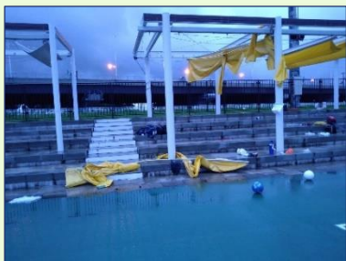
竜巻により観客席の屋根が破損した様子 (セナリオハウスフィールド三郷)
